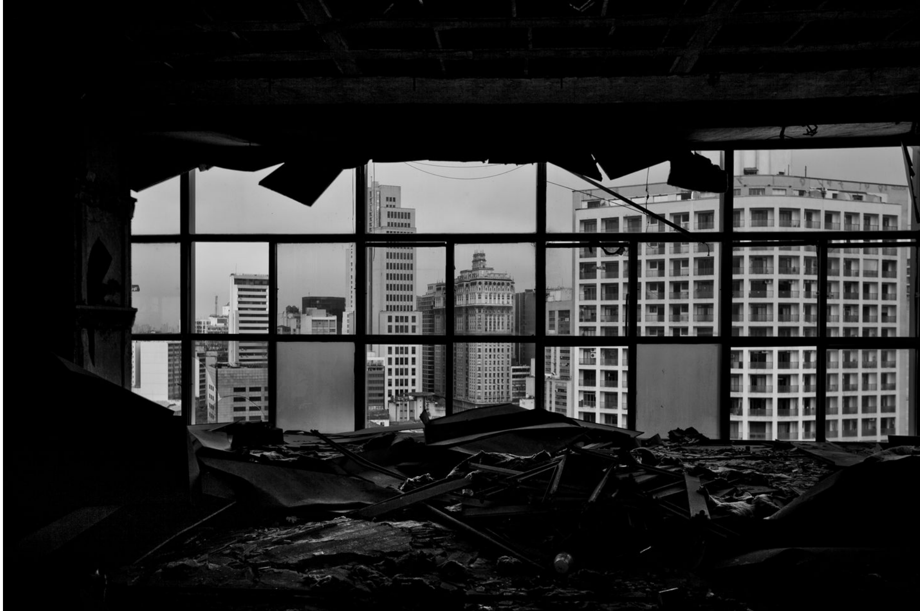
Vista do centro da cidade a partir da ocupação Rio Branco, antigo prédio da Polícia Federal, abandonado quando o órgão público se mudou para outro endereço. Este prédio sofreu um incêndio de grandes proporções no ano passado e caiu deixando ao menos 5 mortos e dezenas de desabrigados.
